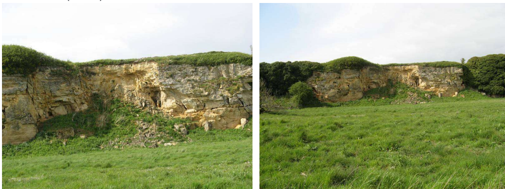
Eboulement/chutes de blocs à Saint-Michel-en-l'Herm
